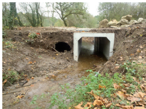
Remplacement d'une buse en métal, sous-dimensionnée, (à gauche) par un pont-cadre (à droite), sur le Bonne Chère.
