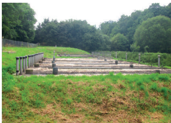
Station d'épuration de la Carneille sur le bassin-versant de la Rouvre.
