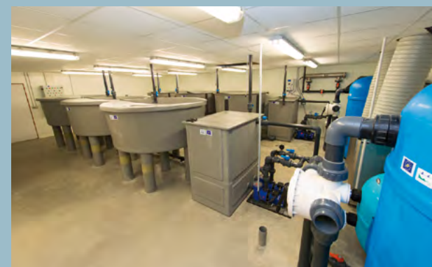
Deux circuits fermés indépendants composés chacun de trois bassins d'élevage et de leurs différents filtres à eau
